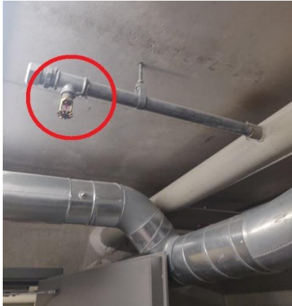
Pildil: Sprinklersüsteem torustiku ja „sprinkleripeaga“
