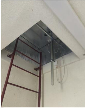
Pildil: Suitsueemaldusluuk evakuatsioonitrepikoja katuslaes.
